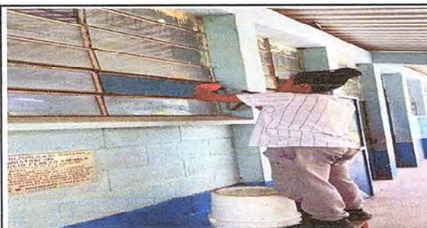
Foto 3: Sustrucción de vidrios de ventanas
